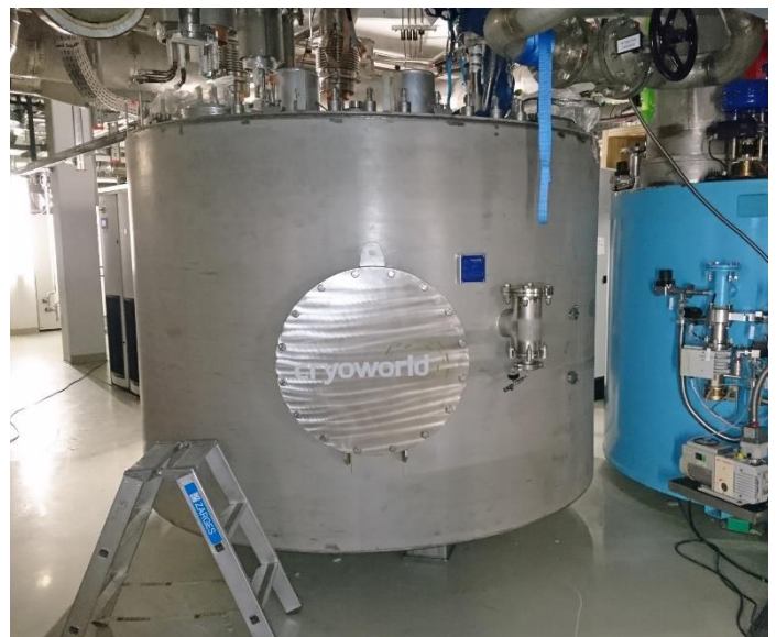
Abb. 2 Kryoventilbox im zweiten Untergeschoss, Foto: IPP, B. Kemnitz
